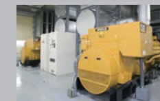
非常用発電設備
