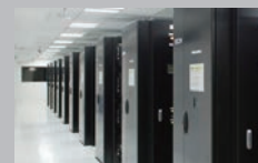
サーバールーム
