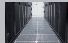
冷気吹き出し口
